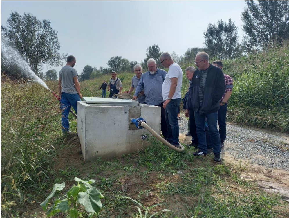
Slika 3. Spojno okno (hidrant) (rujan 2021.)
